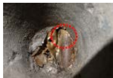
▲グラウト未充填状況
