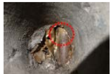
▲グラウト未充填状況
