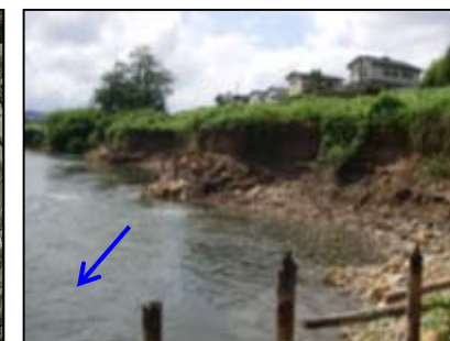
洗掘された河岸
