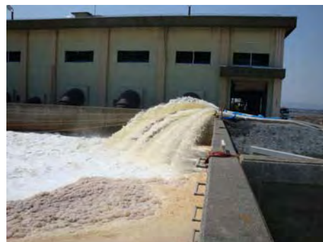
東日本大震災での排水ポンプ排水状況 （福島県沿岸地域）
