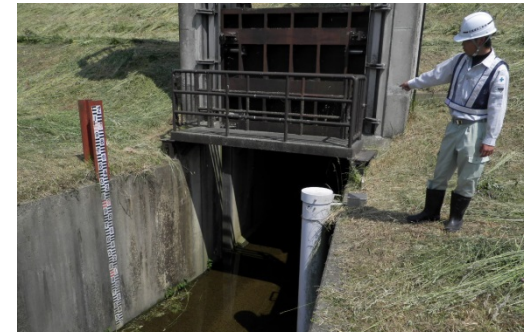
点検及び被災状況の報告
