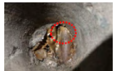
▲グラウト未充填状況
