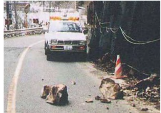
▲現道の落石状況
