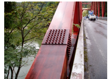
▲ボルト交換前
