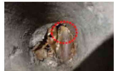
▲グラウト未充填状況
