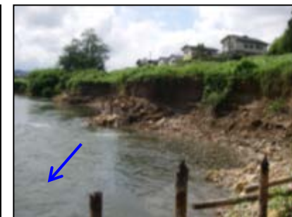
洗堀された河岸
