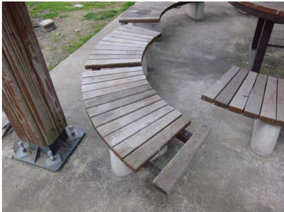
(措置前)ベンチの損傷
