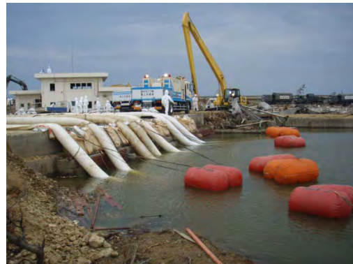
東日本大震災での排水ポンプ設置状況 (福島県沿岸地域)
