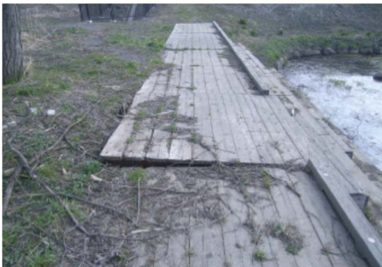
(措置前)デッキの損傷
