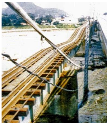
平成元年8月台風13号 河床洗掘により橋脚が転倒した福島 交通線の鉄道橋(上松川橋付近)
