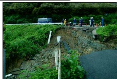
▲国道13号 H14.7.11 土砂崩落(事前通行規制実施中に被災)
