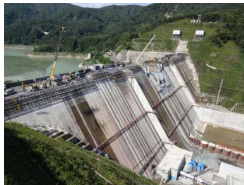
【本体コンクリート打設は、9月30日現在 74メートルの高さに達しました】
