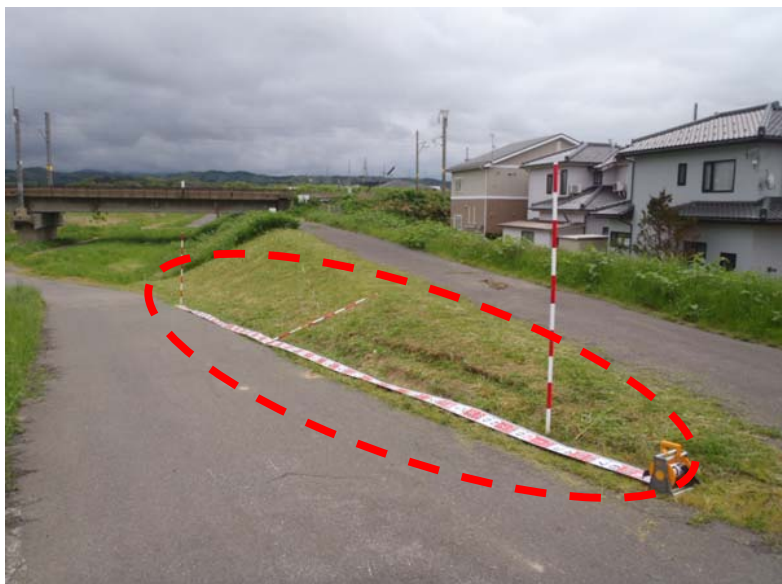
写真①(施工前) 法面にタイヤ痕があり、 雨水の浸透により軟弱化する危険性がある
