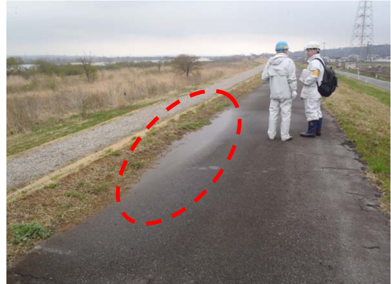
▲ 法肩が舗装面より高いため雨水が溜まる (雨水が浸透し、堤防が軟弱になるため危険)
