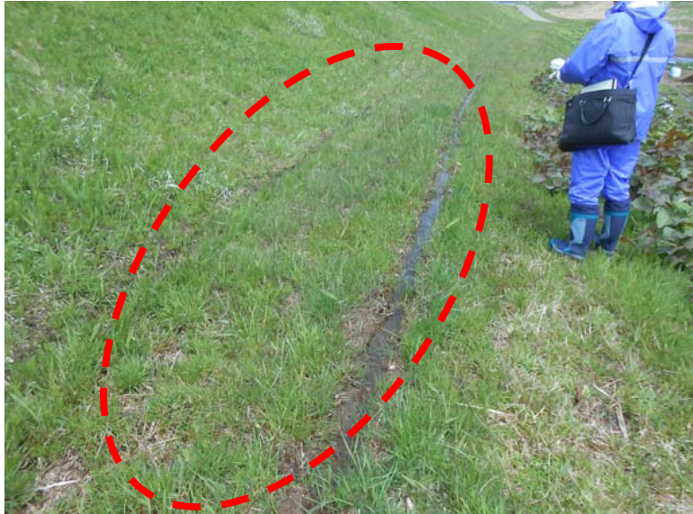
▲ 堤防法尻にタイヤ痕 (雨水が浸透し、芝等が剥離し、堤防が軟弱になるため危険)
