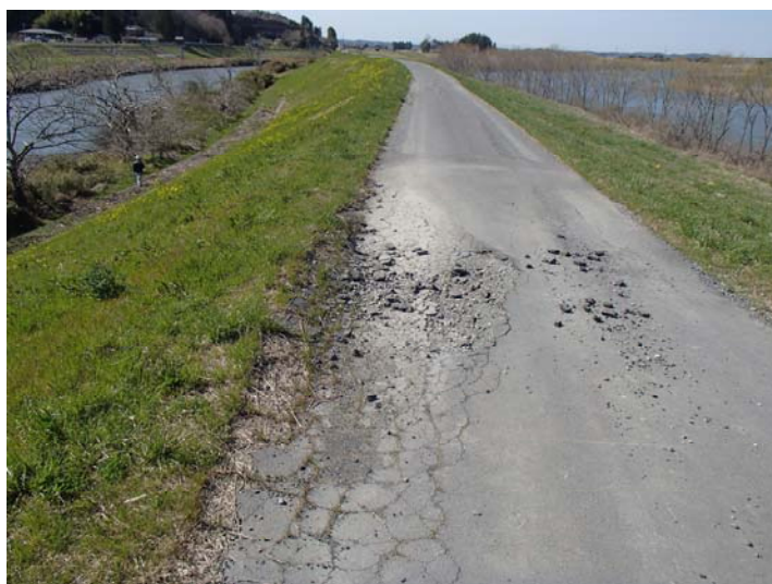
堤防舗装部の損傷
