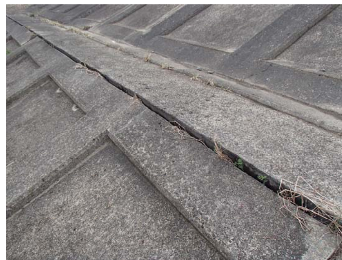
護岸部の損傷
