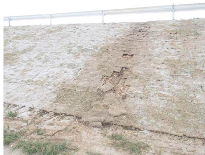
堤防法面の雨水などによる侵食
