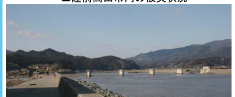
▲国道45号気仙大橋被災状況
