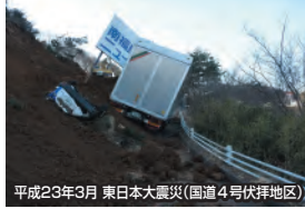
平成23年3月 東日本大震災(国道4号伏拝地区)
