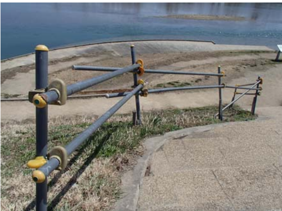
(措置前)階段部の手すりの損傷
