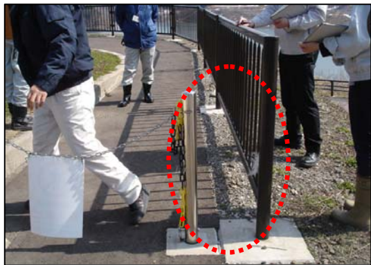
進入規制箇所に隙間があった。(森吉山ダム:広報館周辺)
