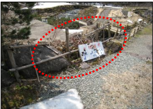
遊歩道の柵が老朽化により損傷していた。(小先達川第一砂防堰堤:サボ-カルチャー)
