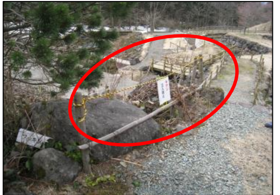
ロープにより応急措置をし、注意看板を設置した。
