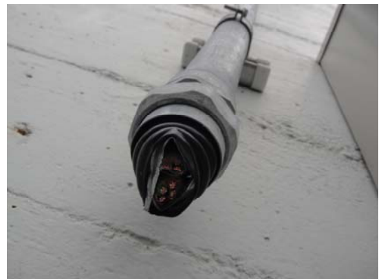
閑上水門発動発電機接続ケーブル切断状況
