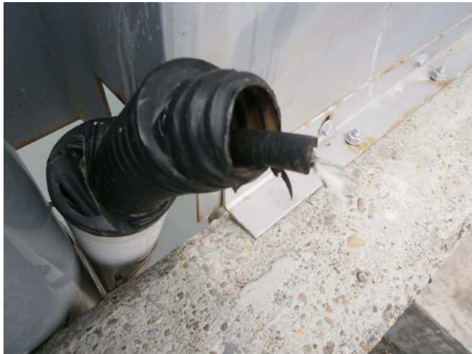
閑上第二水位観測所ケーブル切断状況
