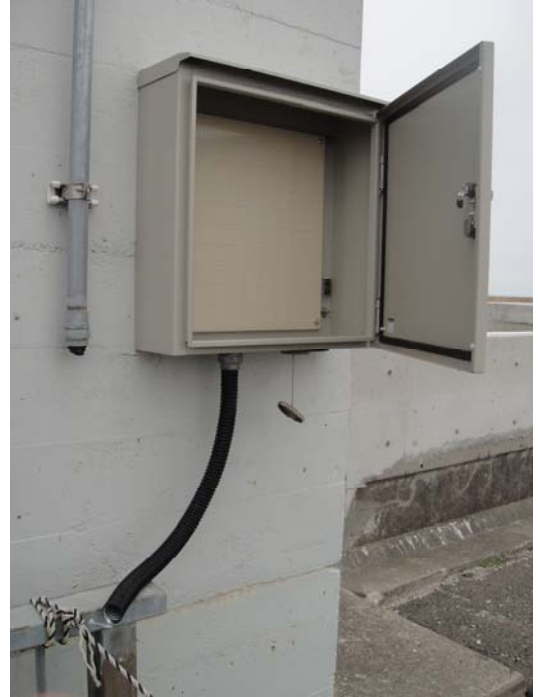
閑上水門ケーブル盗難状況
