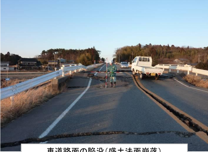
車道路面の陥没(盛土法面崩落)
