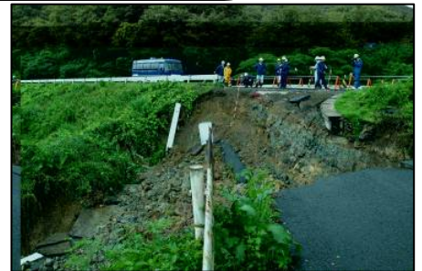
▲国道13号 H14.7.11 土砂崩落 (事前通行規制実施中に被災)
