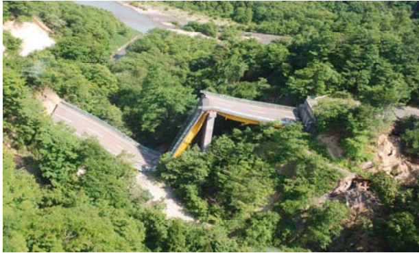
◎平成20年岩手宮城内陸地震により被災した祭時大橋
