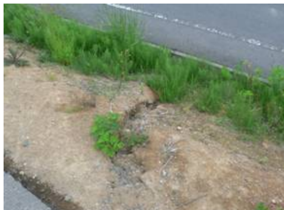
堤防法面の変状
