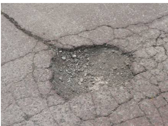
堤防舗装の損傷
