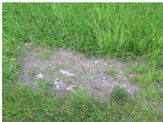
堤防植生の不良
