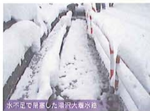
水不足で閉塞した湯沢大堰水路
