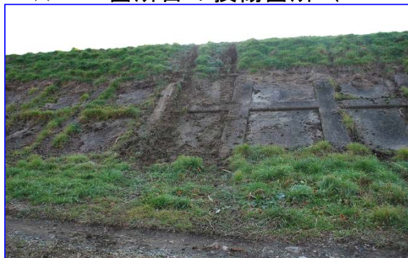
堤防のり面のタイヤ痕跡
