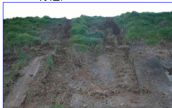
轍掘れによる大きく損傷
