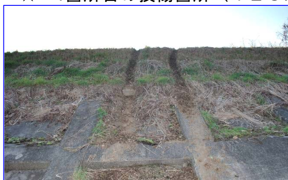
堤防のり面のタイヤ痕跡
