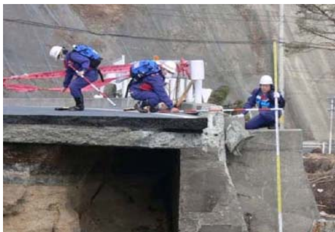
TEC-FORCEの活動状況 (被災状況を共有)
