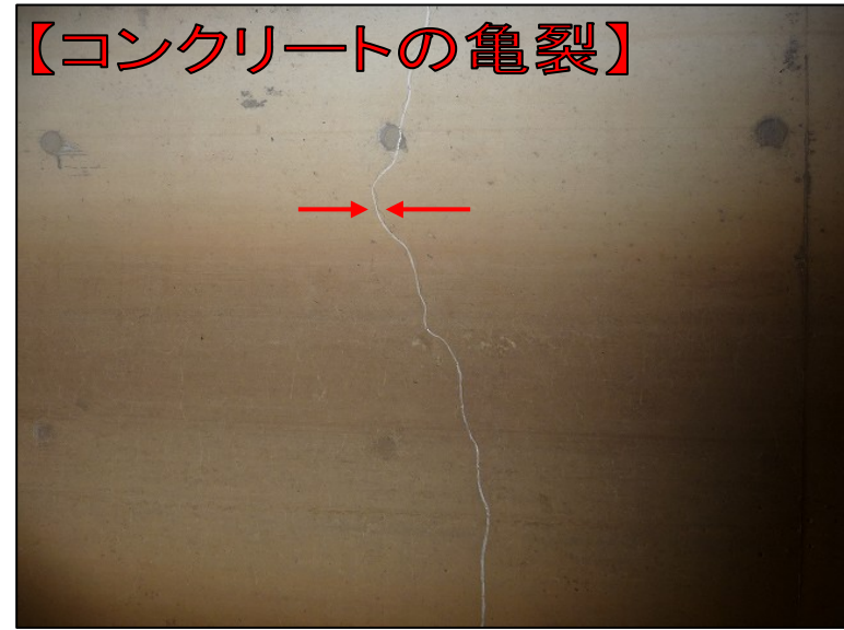
【コンクリートの亀裂】
