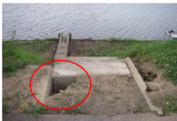
階段付近の土砂が洗掘されていた。(大仙市:中川原河川公園)
