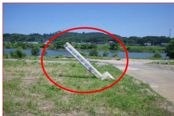
看板柱が倒伏していた。(由利本荘市:せせらぎパーク)
