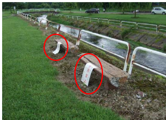
使用禁止札を設置した。
