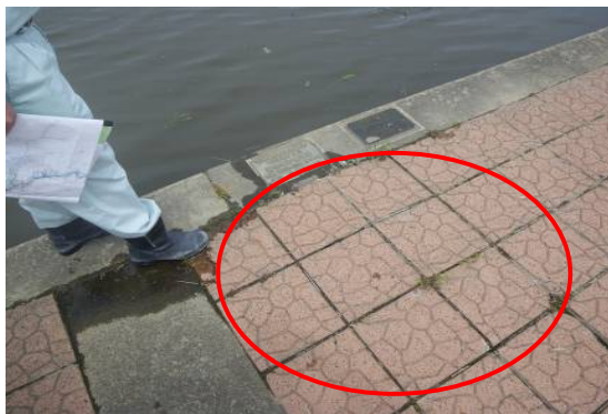
インターロッキングブロックが浮上り、ぐらついていた。(由利本荘市:友水公園)
