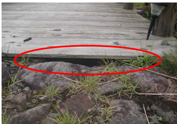
連絡橋に一部隙間があった。(仙北市:小先達川第一砂防堰堤)
