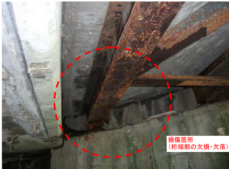
写真2 朝日橋橋側歩道橋(下り) 損傷部分
