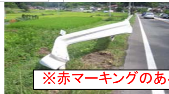
ガードレールの損傷
