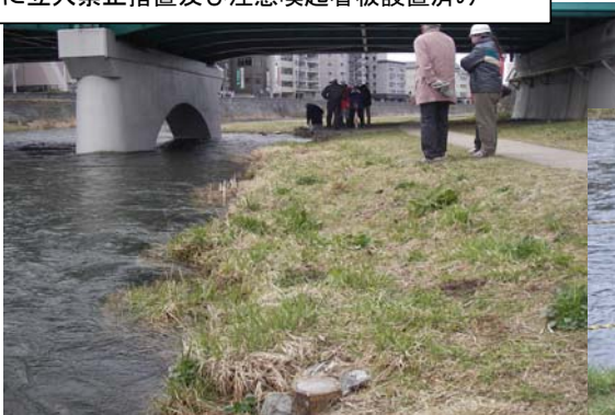
中津川河川公園（中の橋付近）での河岸洗堀の状況 4月19日に立入禁止措置及び注意喚起看板設置済み
