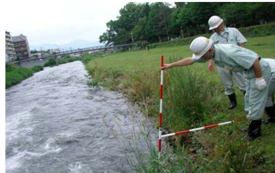
中津川河川公園（中の橋下流）での河岸洗堀状況 7月24日までに立入禁止措置及び注意看板設置予定
