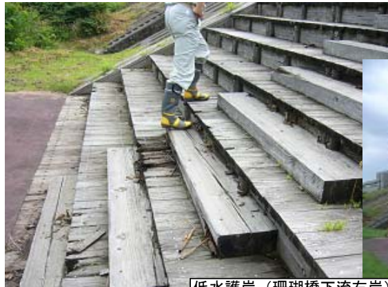
低水護岸（珊瑚橋下流右岸）での 木製階段腐食状況とバリケードによる 立ち入り規制措置状況 7月中に補修予定
