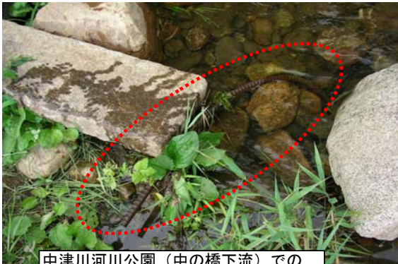
中津川河川公園（中の橋下流）での 河床からの鉄筋露出状況 7月24日までに切断予定
