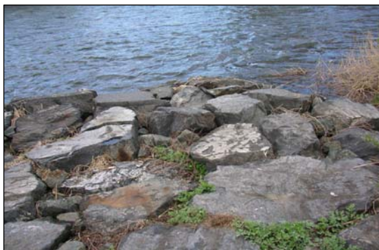
応急処置前 (低水護岸での石の抜け落ち)
