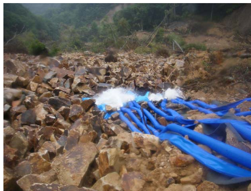
7月8日撮影 湯ノ倉温泉地区 排水吐口
