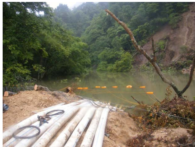
7月8日撮影 湯ノ倉温泉地区 排水呑口
