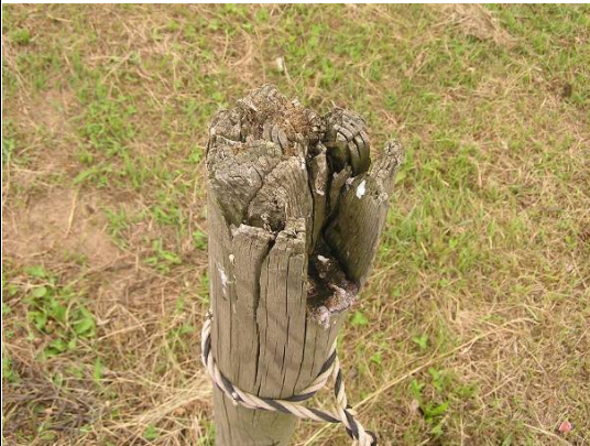
木柱のささくれ
