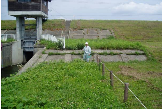
立入防護柵の隙間
