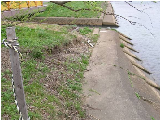
高水敷の洗掘による段差
