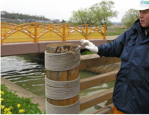
木橋高欄部の破損
