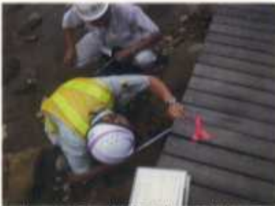
ウッドデッキ踏み板の外れ(1)
