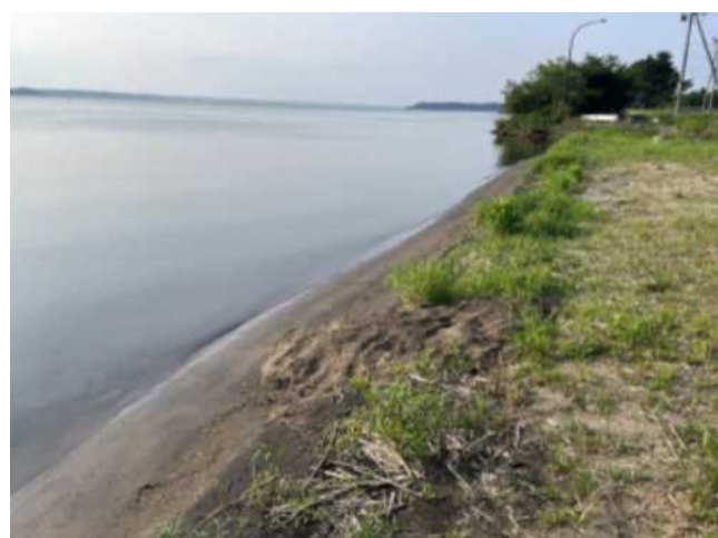
不具合箇所(配水管の露出) 埋設済み
