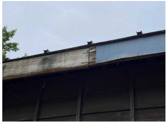
不具合箇所(クラブハウス屋根材の剥がれ) 補修済み
