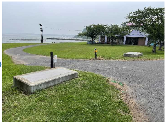
不具合箇所(公園入口モニュメント) 劣化のため撤去済み
