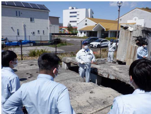
劣化した床版について
