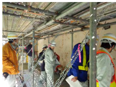
補修工事の足場を使い、普段は 見られない箇所の見学を行いました
