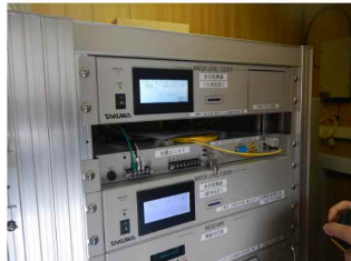
△観測所内 機器点検
