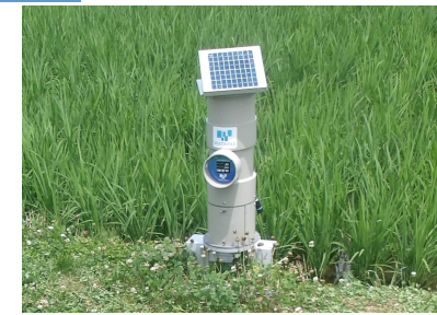
↑排水口に設置された機器 スマートフォンで遠隔操作指示可能
