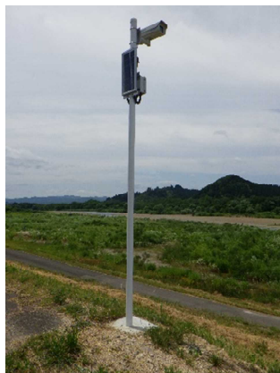
簡易型河川監視カメラ設置状況
