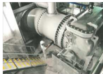
雨水ポンプの整備
