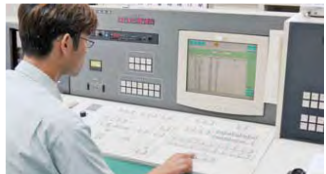
放流警報設備
