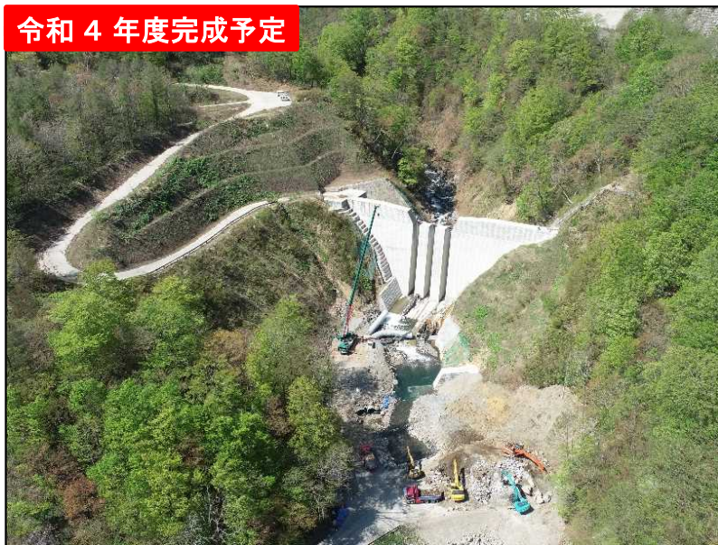
▲シガクラ沢砂防堰堤(R4.5時点)
