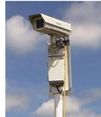
簡易型河川監視カメラ
