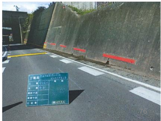
壁面浸水深表示
